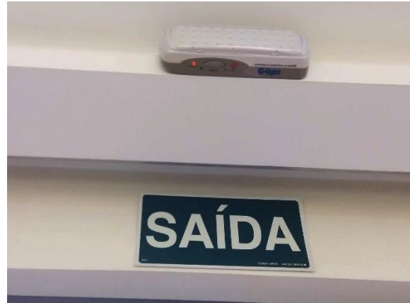
FIGURA 4 – SINALIZAÇÃO DE EMERGÊNCIA Fonte: Autora (2019)
