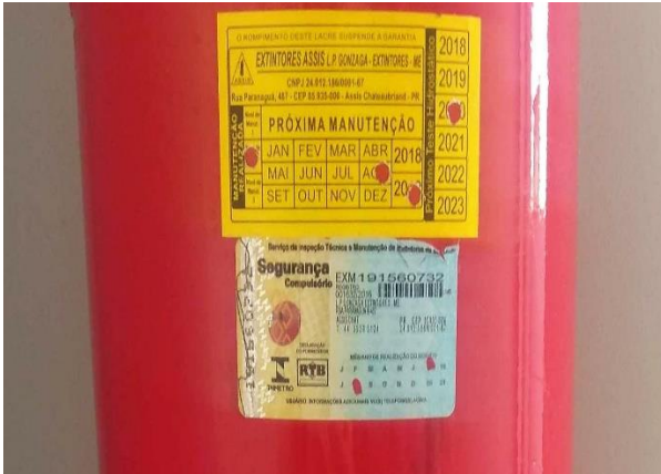
FIGURA 3 – ETIQUETA DE MANUTENÇÃO DO EXTINTOR DE ÁGUA CLASSE A Fonte: Autora (2019)
